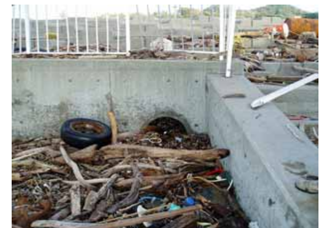
流木と一緒に漂着したゴミ等により、転落防止施設、フラップゲートが破損(新潟県:出雲崎漁港海岸)
