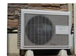
空気熱源ヒートポンプ
