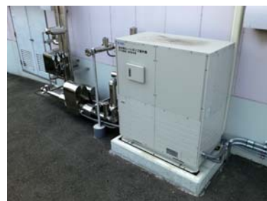
地中熱ヒートポンプ（室外機）
