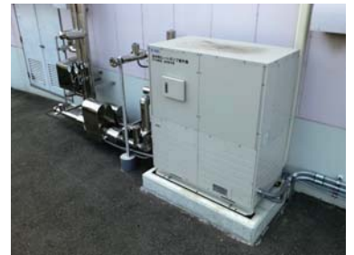
地中熱ヒートポンプ (室外機)
