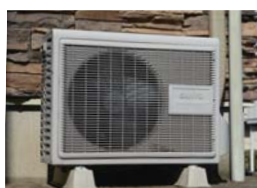
空気熱源ヒートポンプ
