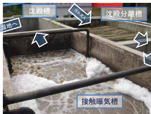
接触曝気槽での処理状況
