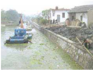
処理施設整備前の排水状況
