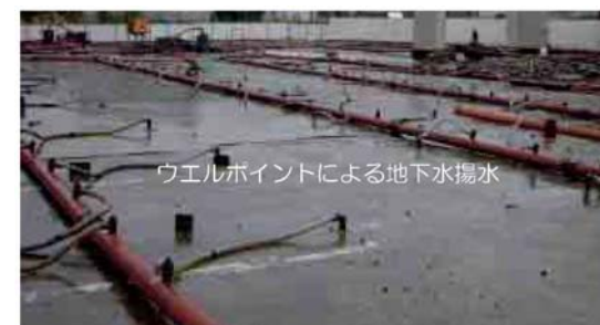
図 4-11 地下水揚水の概況写真
