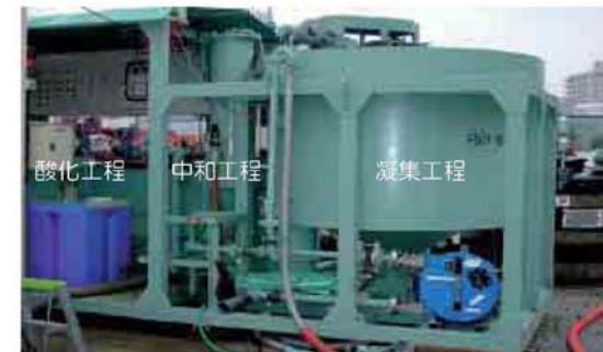
図 4-12 酸化、中和、凝集装置の概況写真
