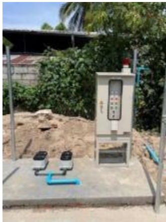
ブロウと制御盤
