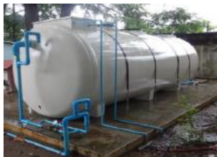
近畿地方181件 (例:滋賀県の浄化槽)
