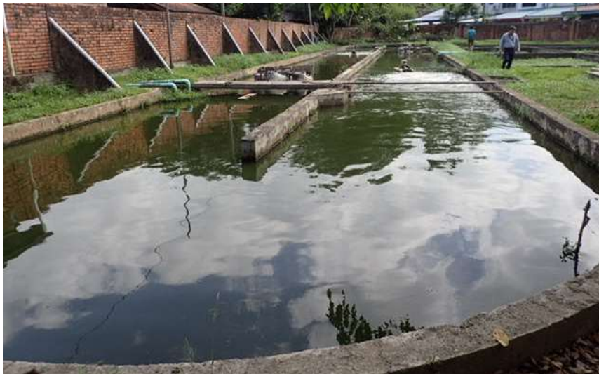
郊外で確認されたオキシレーションディッチ (1,000PE)
