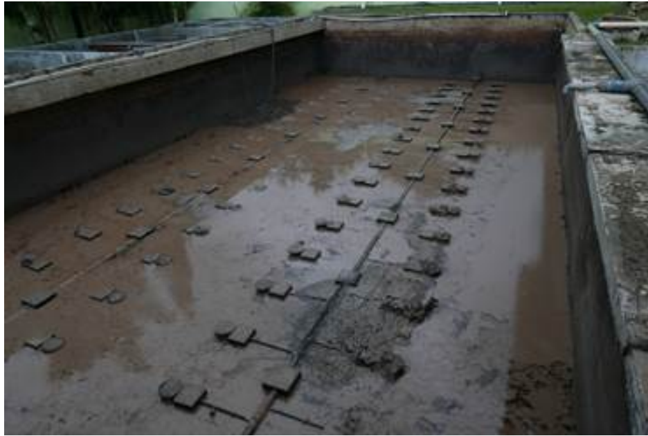
曝気槽の排水、ディフューザー撤去 (汚泥の堆積・ディフューザーの破損・閉塞を確認)
