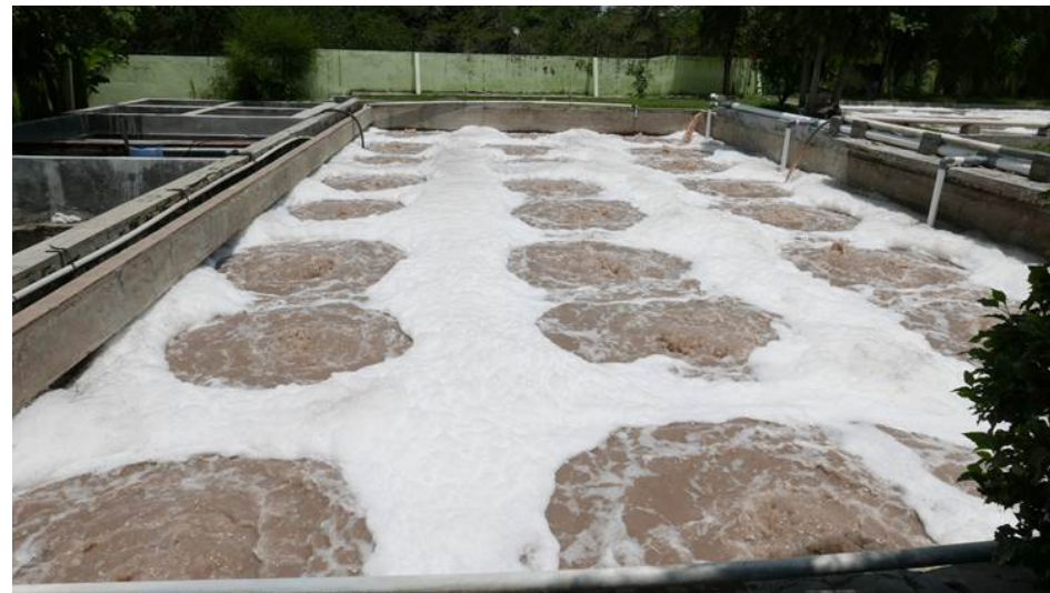
エアレーターの試運転(エアレーターによる攪拌水流の確認)
