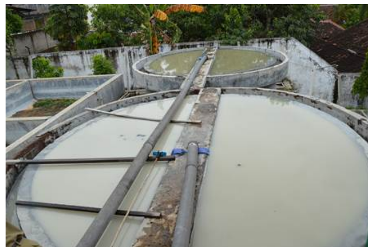
凝集沈殿槽での不完全な分離
