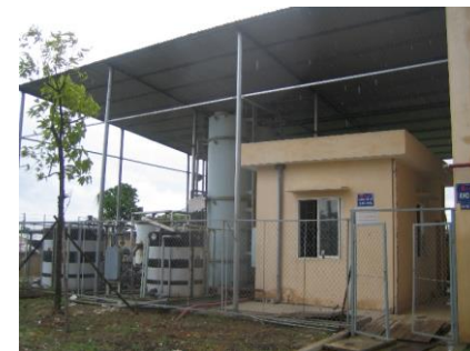
<排水処理施設>
