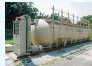
実証試験時の浄化槽
