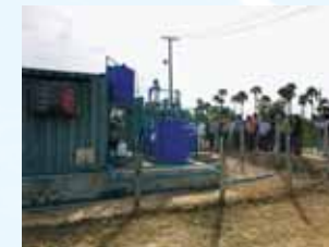
実証運転に用いた排水処理装置
