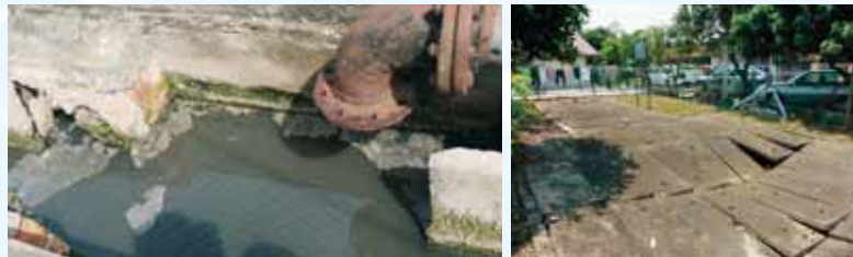
左: CST施設からの放流水 右: 老朽化したCST施設
