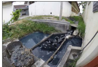
排水の排出状況
