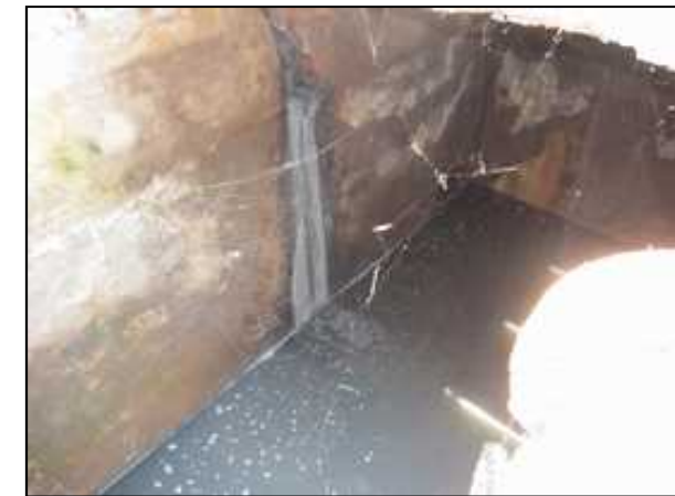
同現場の放流水
