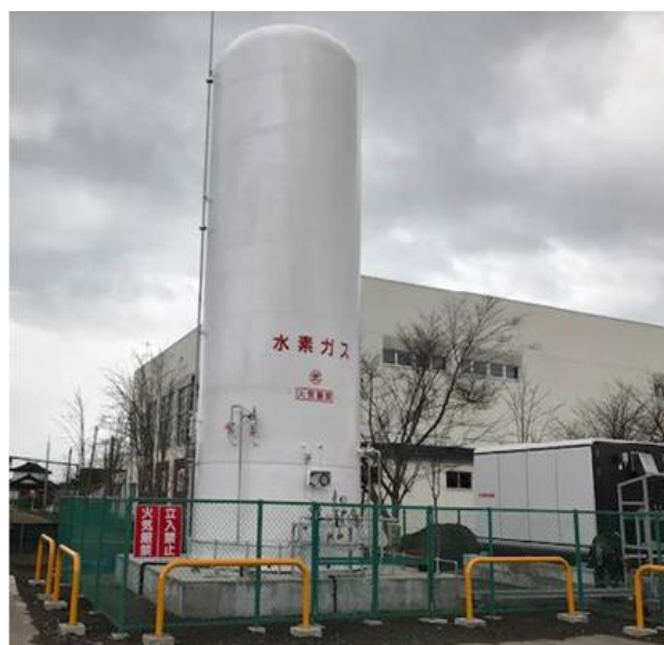
図 20 水素貯蔵タンク
