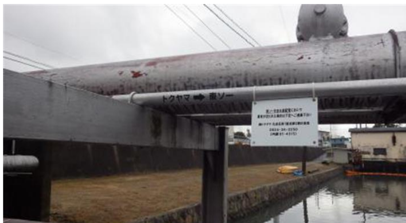
図 13 コンビナート接続導管
