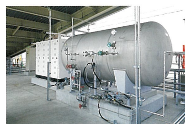
バッファタンク
