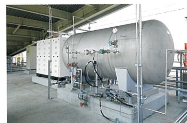
バッファタンク
