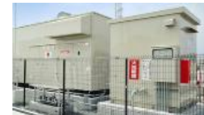
バイオディーゼル非常用発電機
