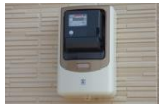
スマートメーター
