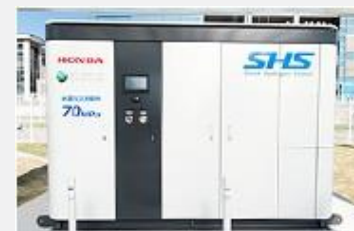
水素ステーション
