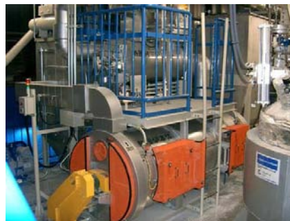
図6 無機物乾燥パイロット実証設備
