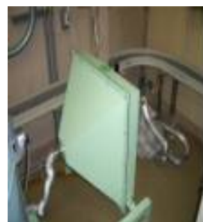
図6 排気処理装置
