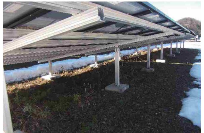
発生ガス対策のため、耐食性に優れた架台（構造部材：アルミ製、ネジ類：ステンレス製）を採用
