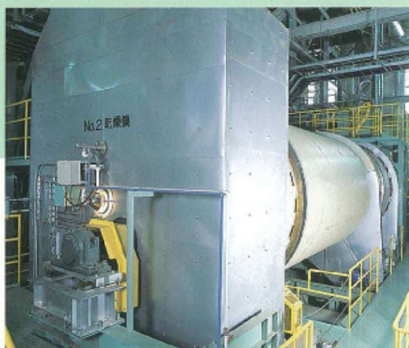
■ 乾燥機 (直接熱風式ロータリーキルン方式)
