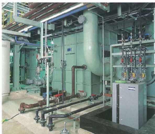
■ 排ガス脱臭装置 (湿式オゾン酸化方式+活性炭吸着方式)
