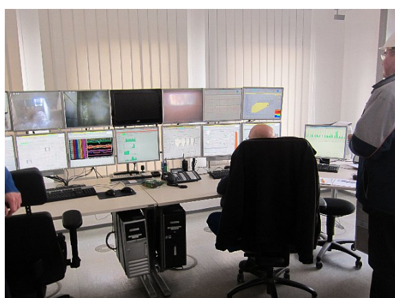
写真 E-6 中央制御室
