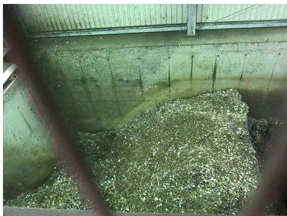
写真 D-7 メタン発酵/原料ピット
