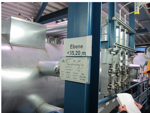
写真 E-7 ボイラ
