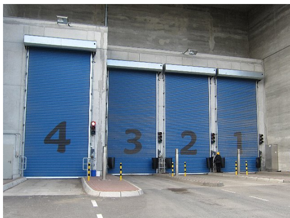
写真 E-3 ごみピット投入扉
