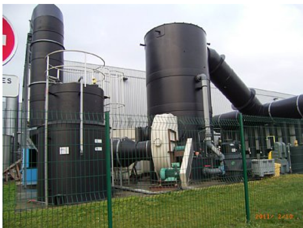
写真 F-9 脱臭設備
