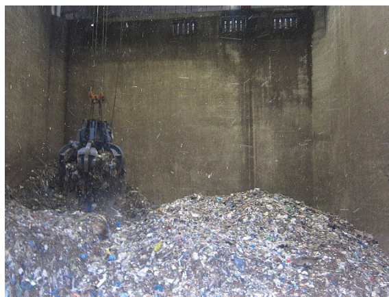
写真 E-4 ピット・クレーン
