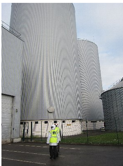
写真 F-5 メタン発酵槽
