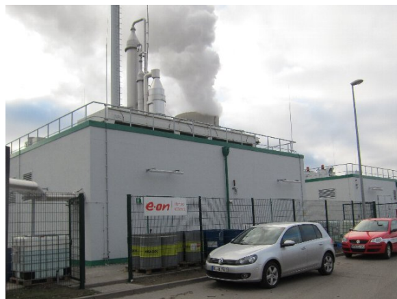
写真 D-6 バイオガス発電施設
