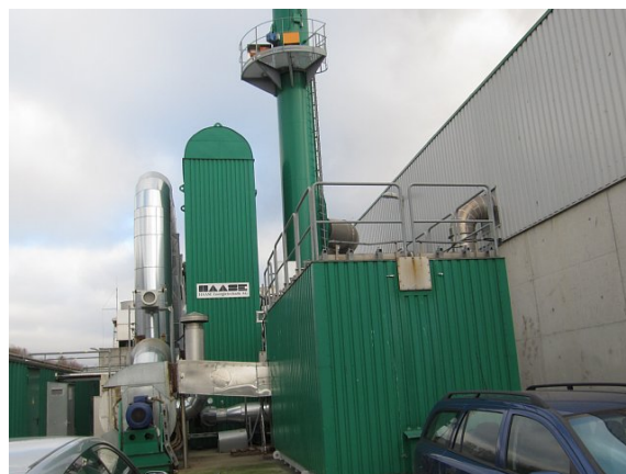
写真 D-4 バイオフィルター
