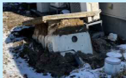
地震により浮き上がった浄化槽
