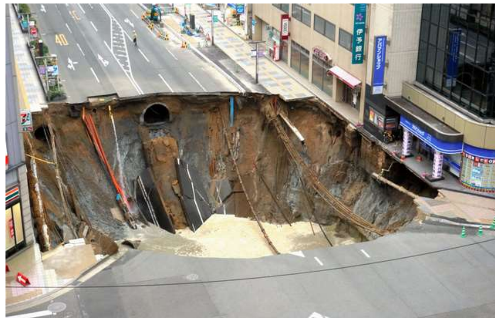
博多駅前の道路陥没、朝日新聞デジタル、2016年11月
