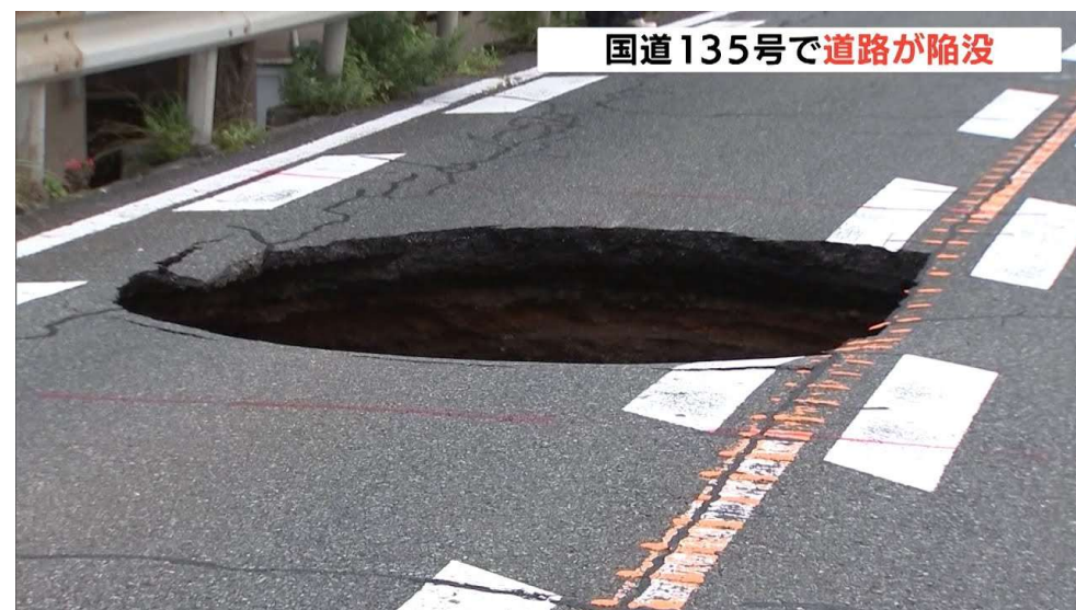
国道135号の道路陥没（静岡県）、2020年7月、SBS 9
