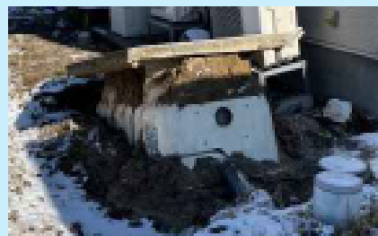
地震により浮き上がった浄化槽
