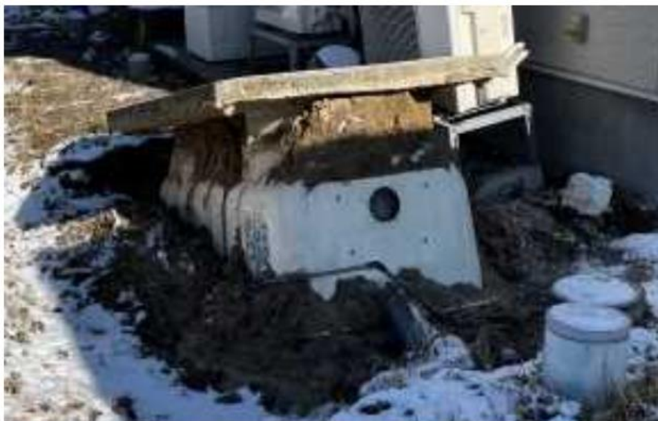
地震により浮き上がった浄化槽
