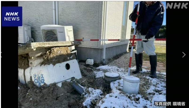
出典: NHK NEWS WEB (珠洲市住宅用浄化槽被災状況) 2024年2月18日
