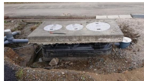
洪水により浄化槽が露出した例
