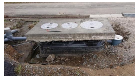
洪水により浄化槽が露出した例
