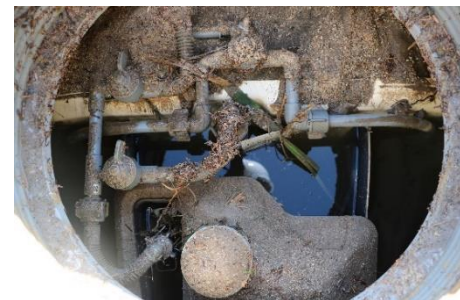
浄化槽内に土砂が流入した例
