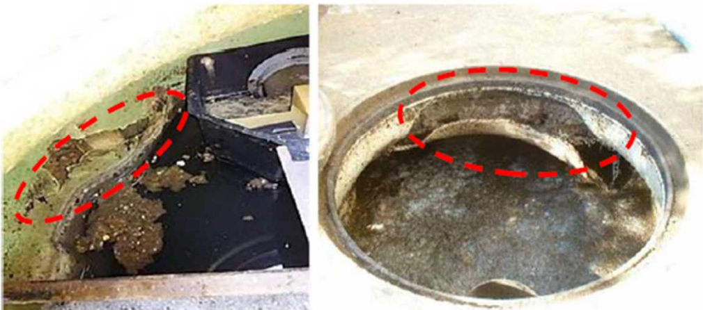
■水面より上の槽壁が破損
