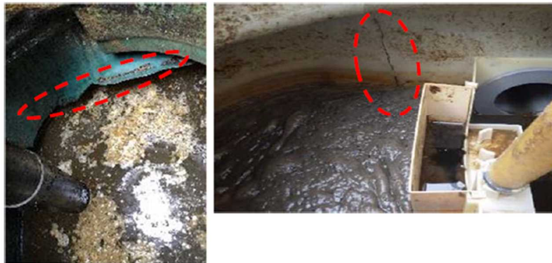
■上部から水面下まで亀裂（漏水を伴う）
