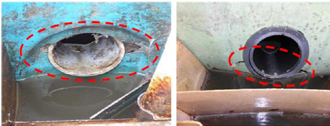
■放流管接合部の破損
