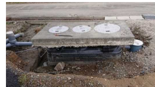
洪水により浄化槽が露出した例
