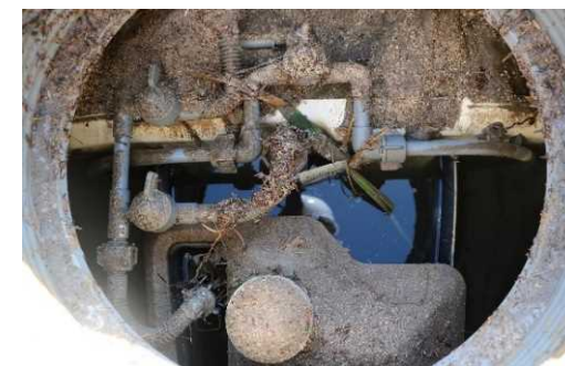
浄化槽内に土砂が流入した例
