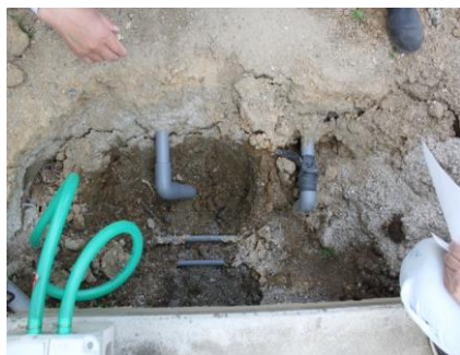
空気配管の破損(槽外空気配管)をホースで応急措置した例
