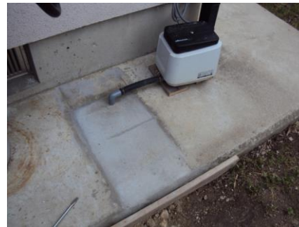
槽外空気配管を修補 (完全に修理されていた例: 簡便な工事は迅速に行われている事例があった)
