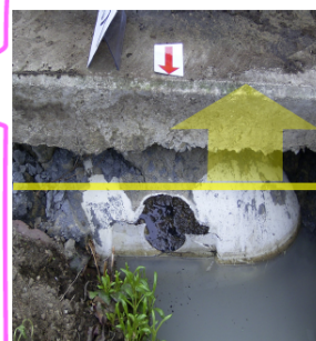
接続部が破損し、漏水している例
