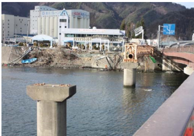
落下した水管橋 平成23年3月28日
