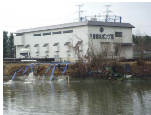
仮設ポンプによる排水状況 (多賀城市 八幡雨水ポンプ場)
