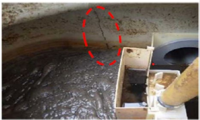
特定既存単独槽の例 （漏水を伴う亀裂）
