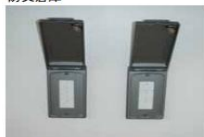
一般の電話回線が混雑しても優先的に使用できる特設公衆電話用ジャック
