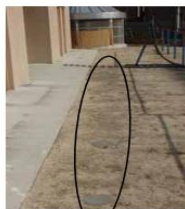
非常時にトイレとして使用できるマンホールトイレ
