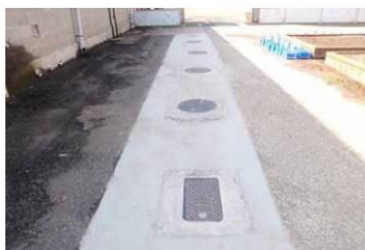
非常時にトイレとして使用できるマンホールトイレ
