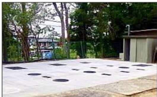
写真2.4 豊橋市立天伯小学校に設置 された浄化槽(RC製)
