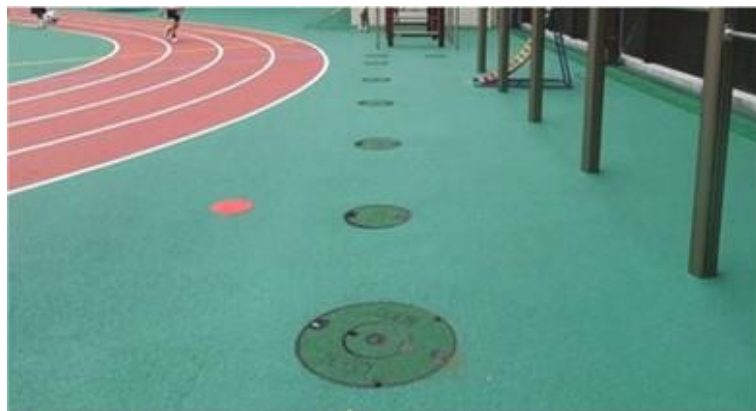
写真3-1 学校に整備されたマンホールトイレ
