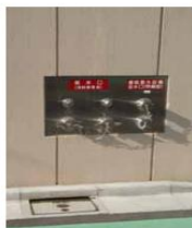
屋上プールの水を消火に使用できる消防用採水口
