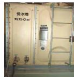
水を取り出せる水栓を備えた受水槽
