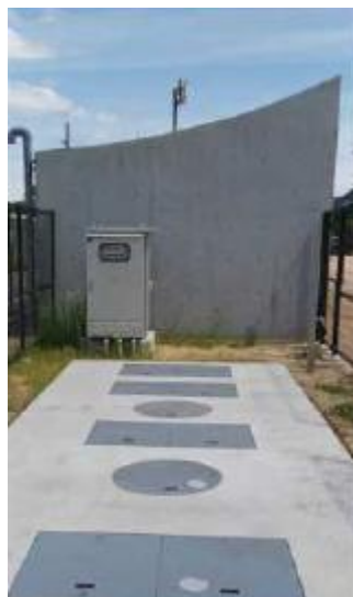
写真2.2 マンホールトイレに対応 した浄化槽
