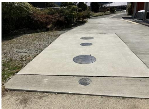
設置浄化槽（FRP 製）
