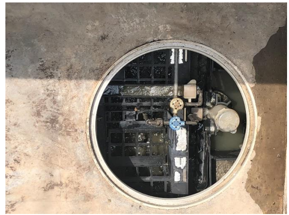
ばっ気槽 (A 宅)
