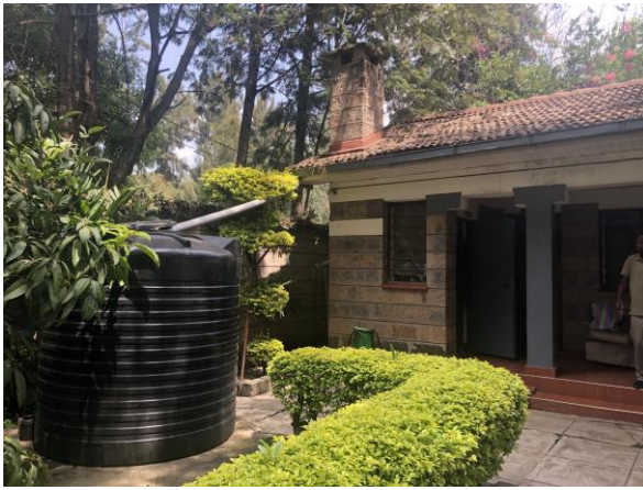
雨水回収タンク (A 宅)
