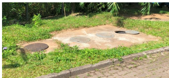
浄化槽の設置状況
