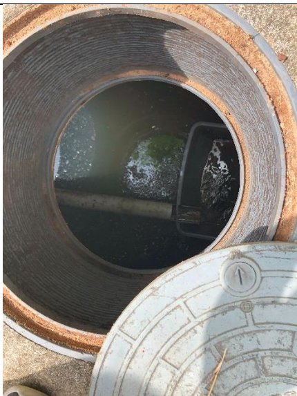
夾雑物除去槽
