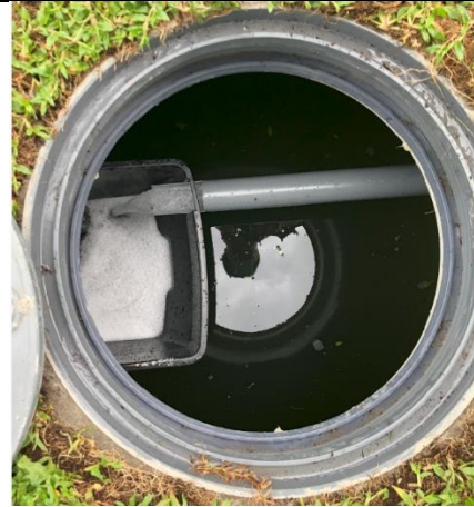
夾雑物除去槽
