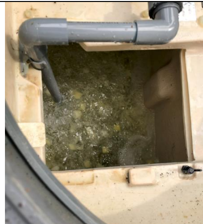
供用開始直後の担体流動槽
