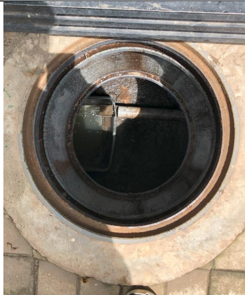
夾雑物除去槽
