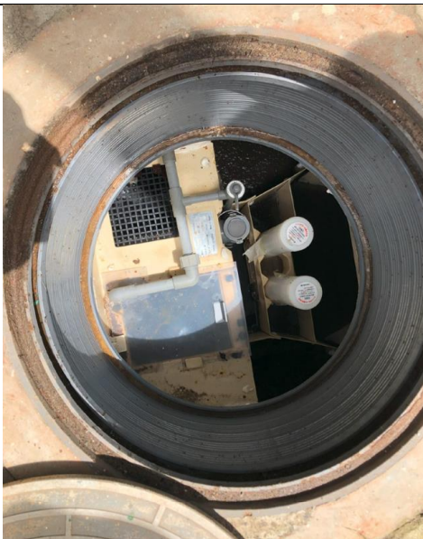
担体流動槽・沈殿槽・消毒槽
