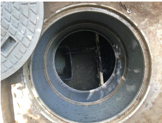
沈殿分離槽 (B 宅)
