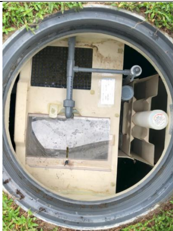
担体流動槽・沈殿槽・消毒槽
