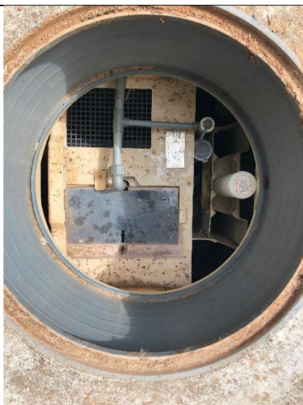
担体流動槽・沈殿槽・消毒槽
