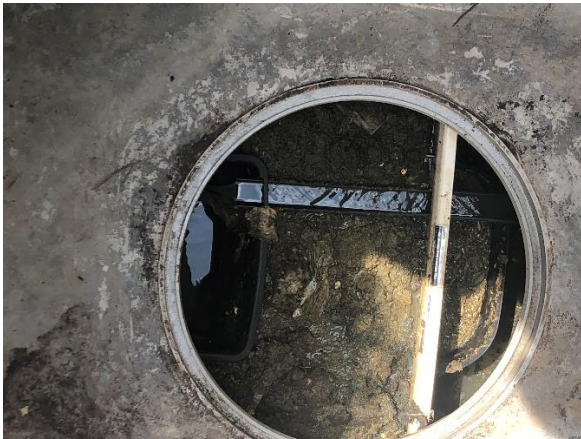
沈殿分離槽 (A 宅)
