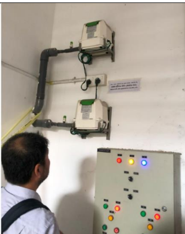
制御盤とブロワ
