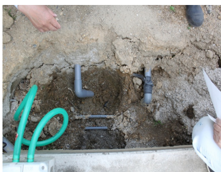
空気配管の破損(槽外空気配管)をホースで応急措置した例
