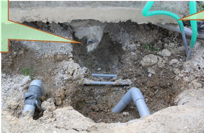
(引用:平成23年度 東日本大震災浄化槽被害状況緊急調査(福島県)報告書)
