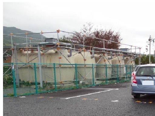
複数基設置された浄化槽
