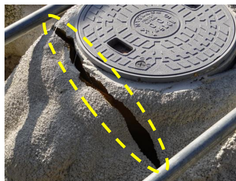
ウレタン塗装の亀裂
