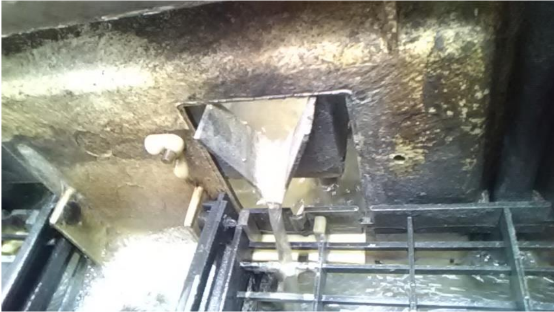
NO.11 流量調整装置の固定具（白色のビスが右側にはあるが、左側は欠落）が欠落している。
