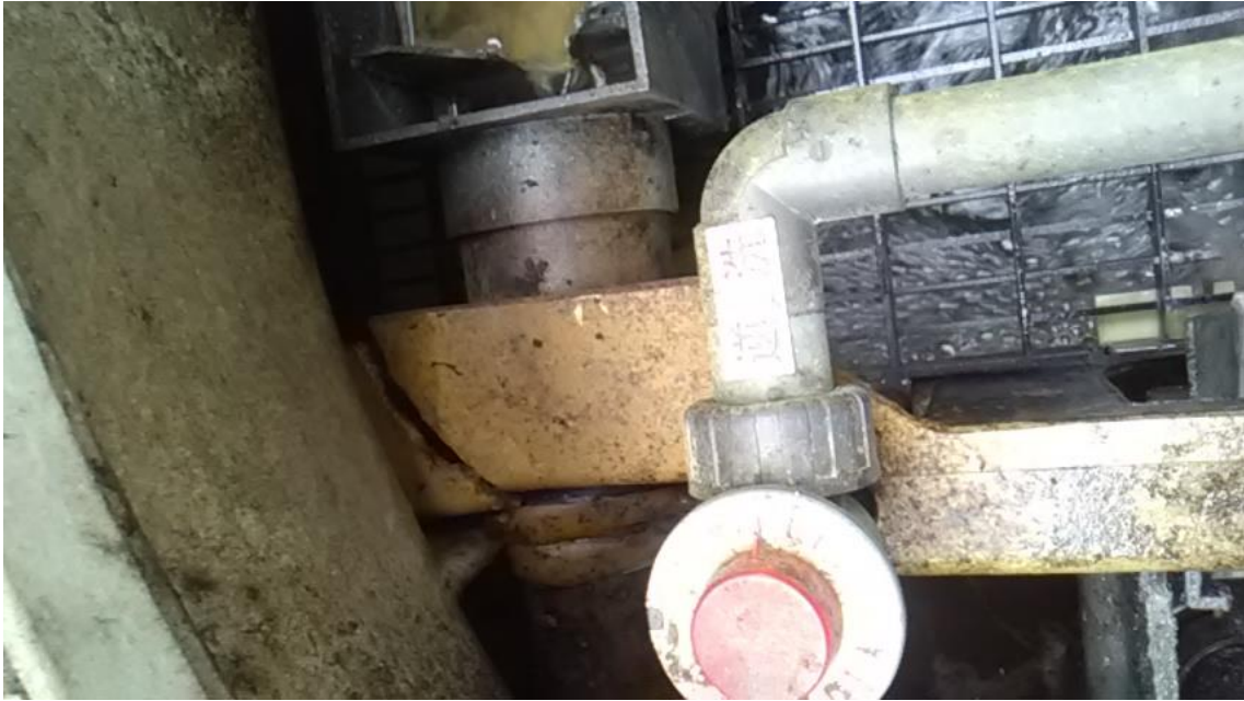
NO.5 生物ろ過槽と嫌気ろ床槽との隔壁上部に割れが認められる（劣化によるものと思われる）
