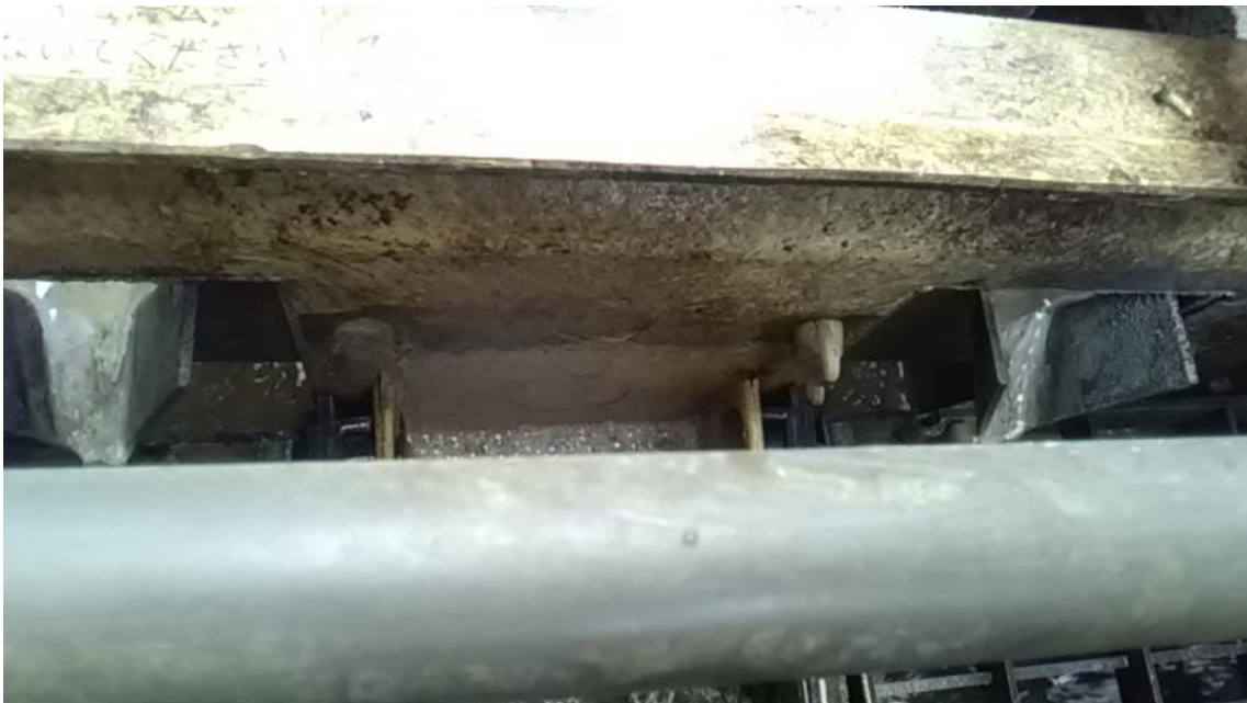
NO.10 流量調整装置の固定具（写真中央左）が欠落している。
