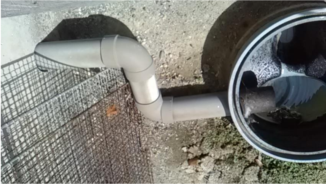
NO.17 流入配管露出のため、紫外線による劣化が認めらる。
