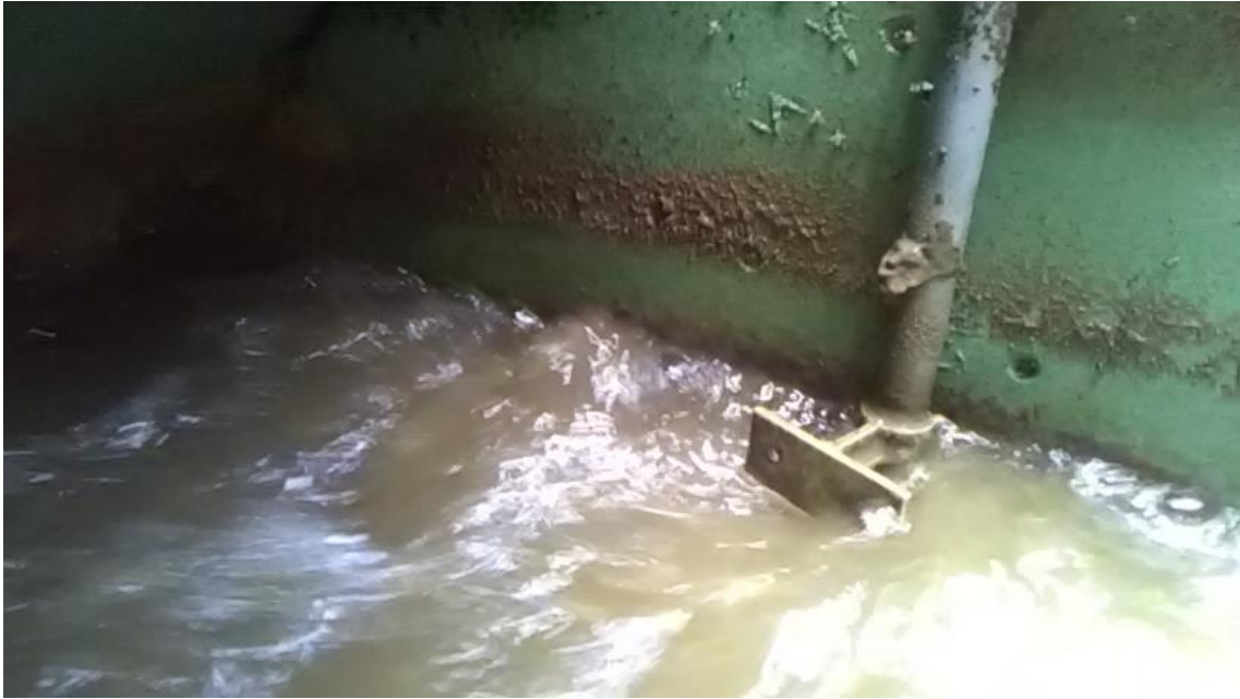
NO.13 接触ばっ気槽逆洗管固定具のリベット腐食欠落のため、固定具が外れている。
