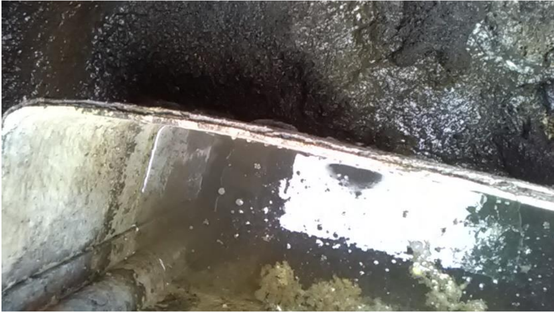
NO.9 嫌気ろ床槽清掃口隔壁に劣化が認められる。
