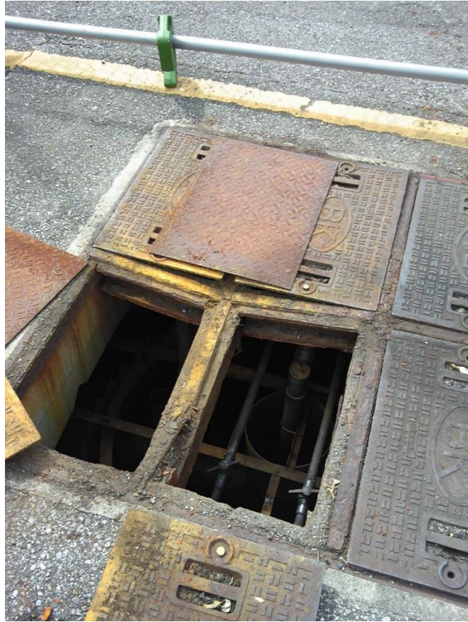
NO.21 マンホール蓋の受け沈下、密閉不良、往来に危険を伴う状況。
