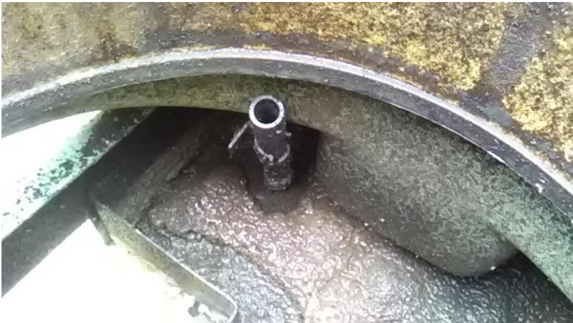
NO.14 嫌気ろ床槽のろ材押さえパイプホルダーのリベット腐食欠落のため、固定具が外れている。
