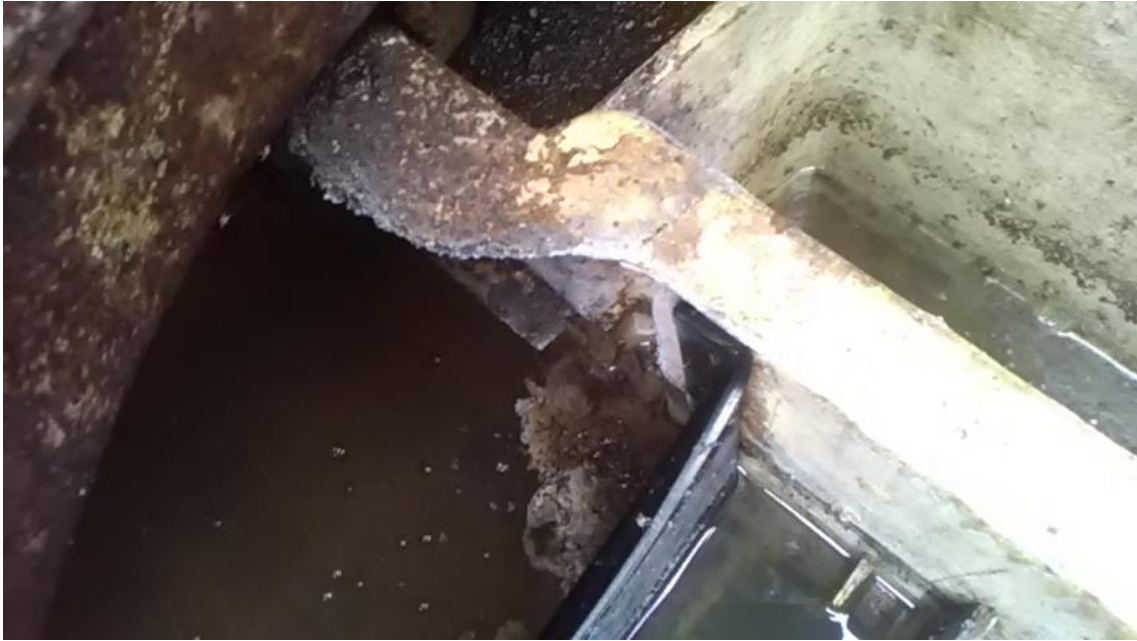
NO.7 嫌気ろ床槽隔壁に劣化が認められる。
