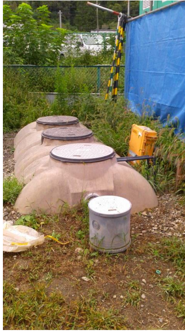
NO.23 躯体上部が露出して設置されている。躯体の保護措置が施されていないため、紫外線による劣化が数年で進行する恐れがある。
