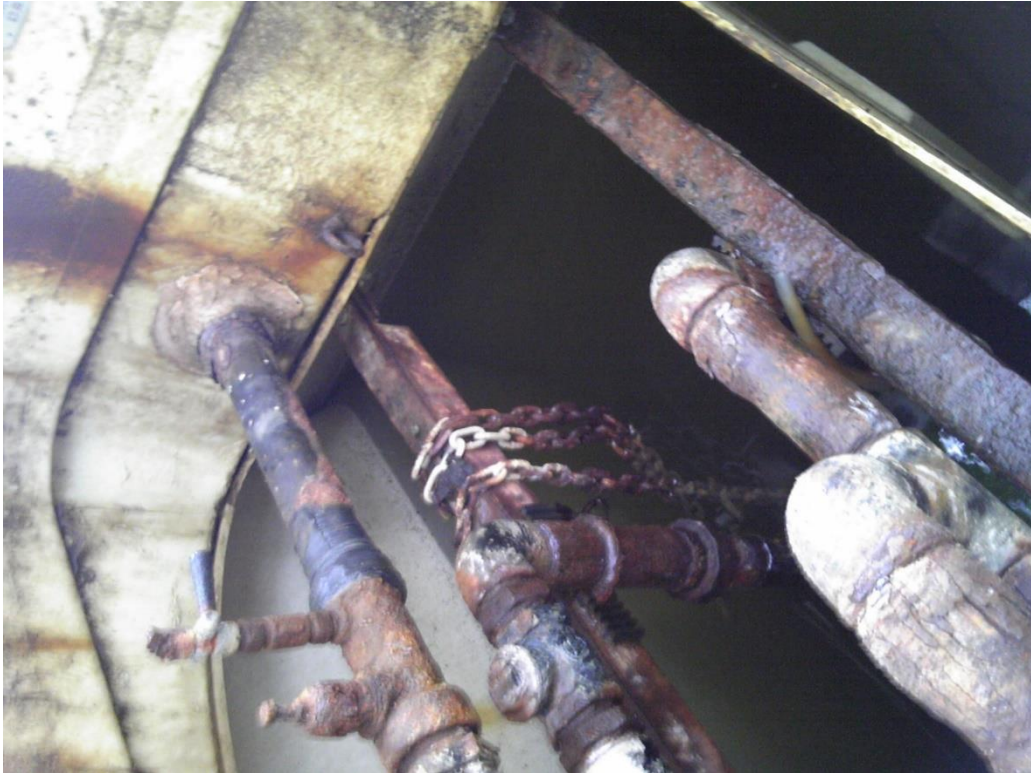
NO.25 隔壁の劣化、送気管・送気バルブの腐食劣化、バルブの欠落等が認められる。
