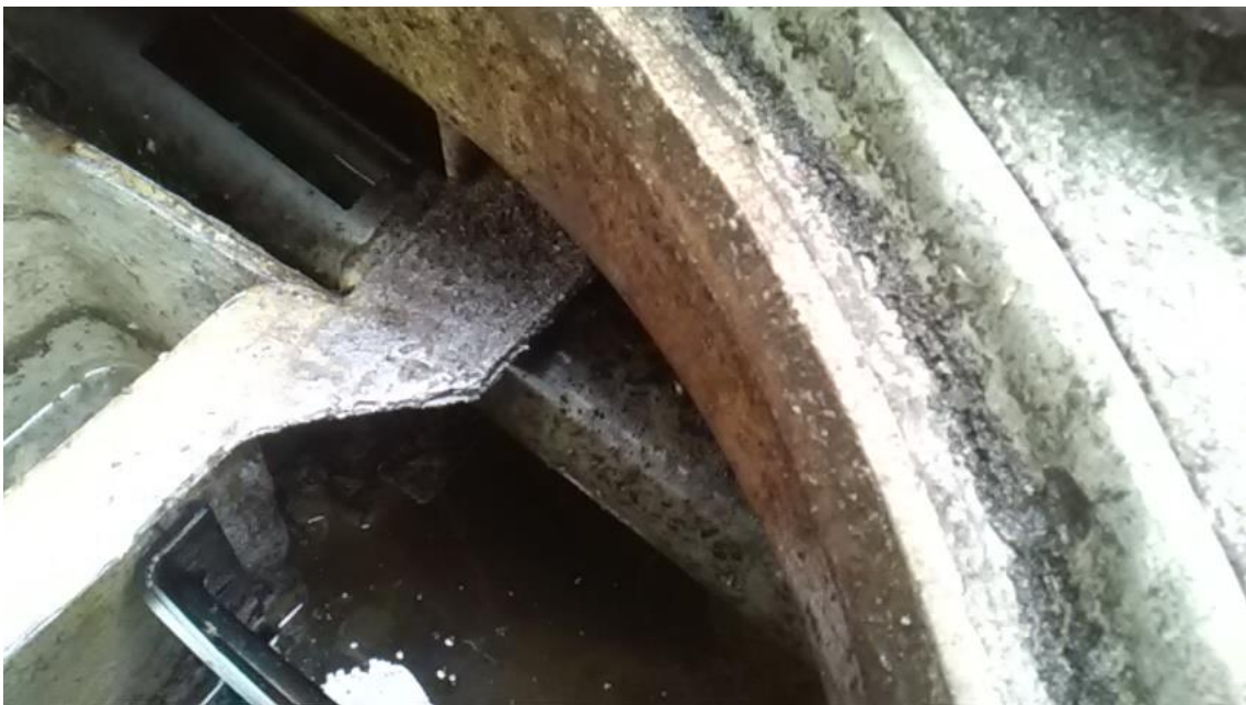
NO.8 嫌気ろ床槽隔壁に劣化が認められる。
