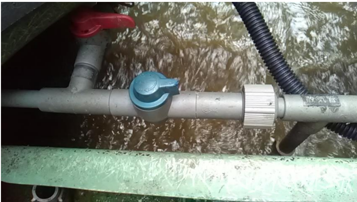
NO.18 散気用バルブハンドルが破損している。
