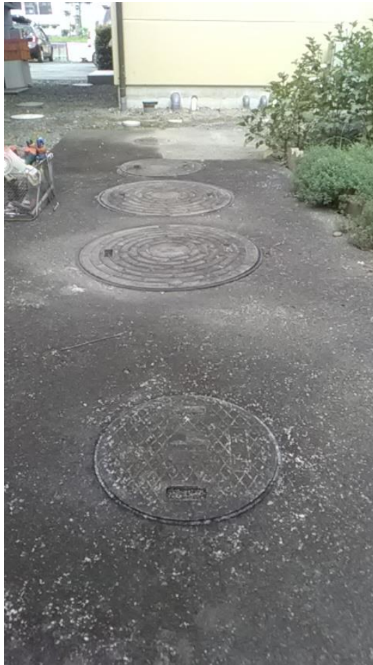
NO.12 槽上部の様子、マンホール蓋表面にやや劣化が見られるが人が乗って危険な状態ではない。
