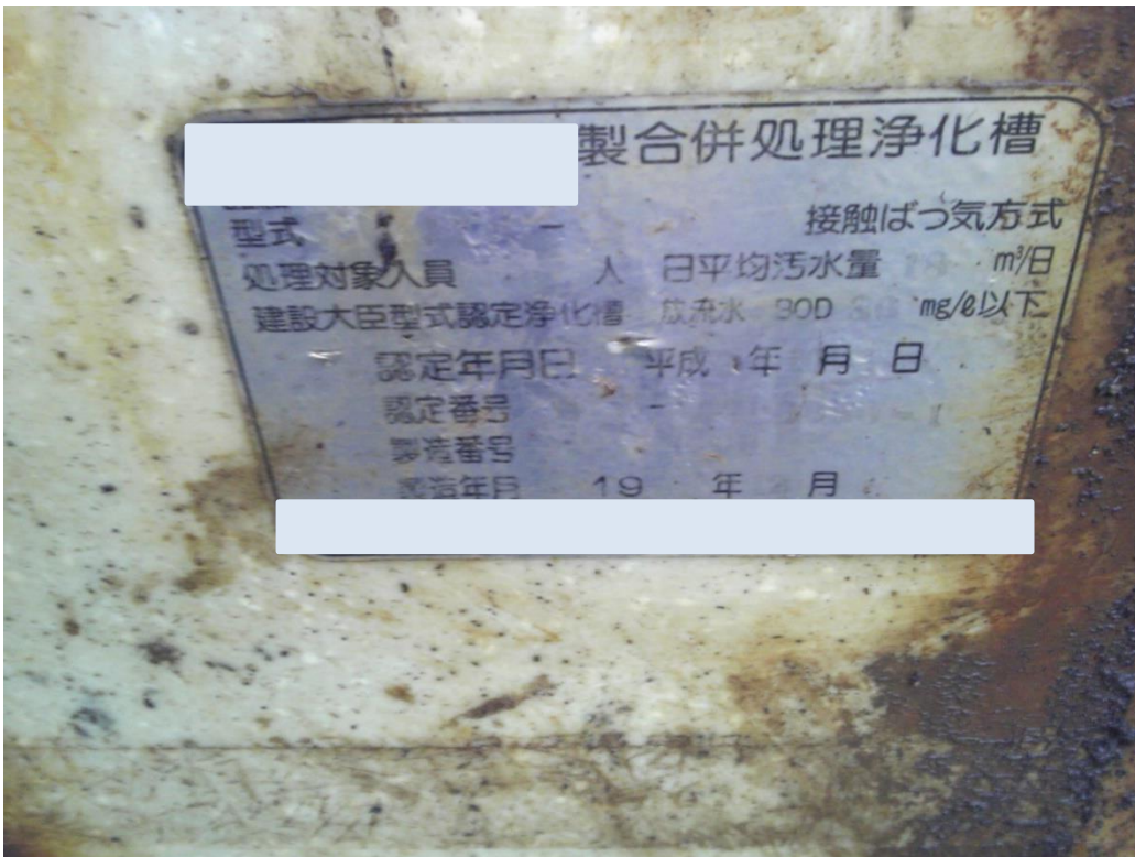
NO.26 NO.24、NO.25 の浄化槽の銘板
