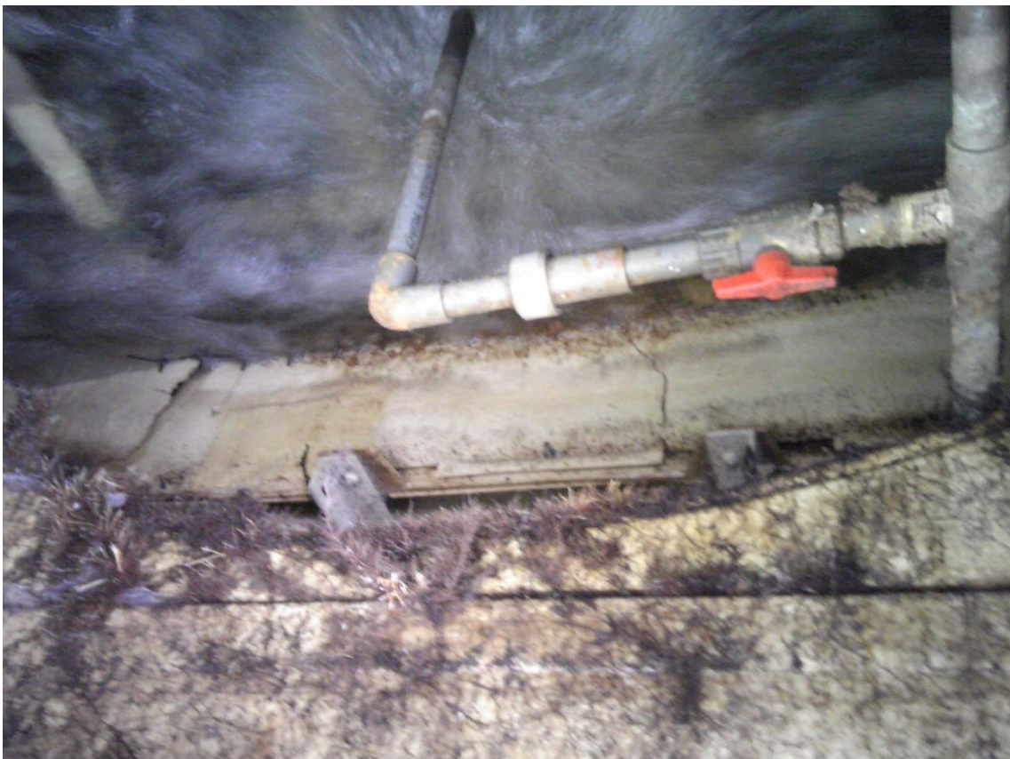
NO.24 接触ばっ気槽と沈殿分離槽の隔壁の劣化。(剥離、亀裂が認められる)
