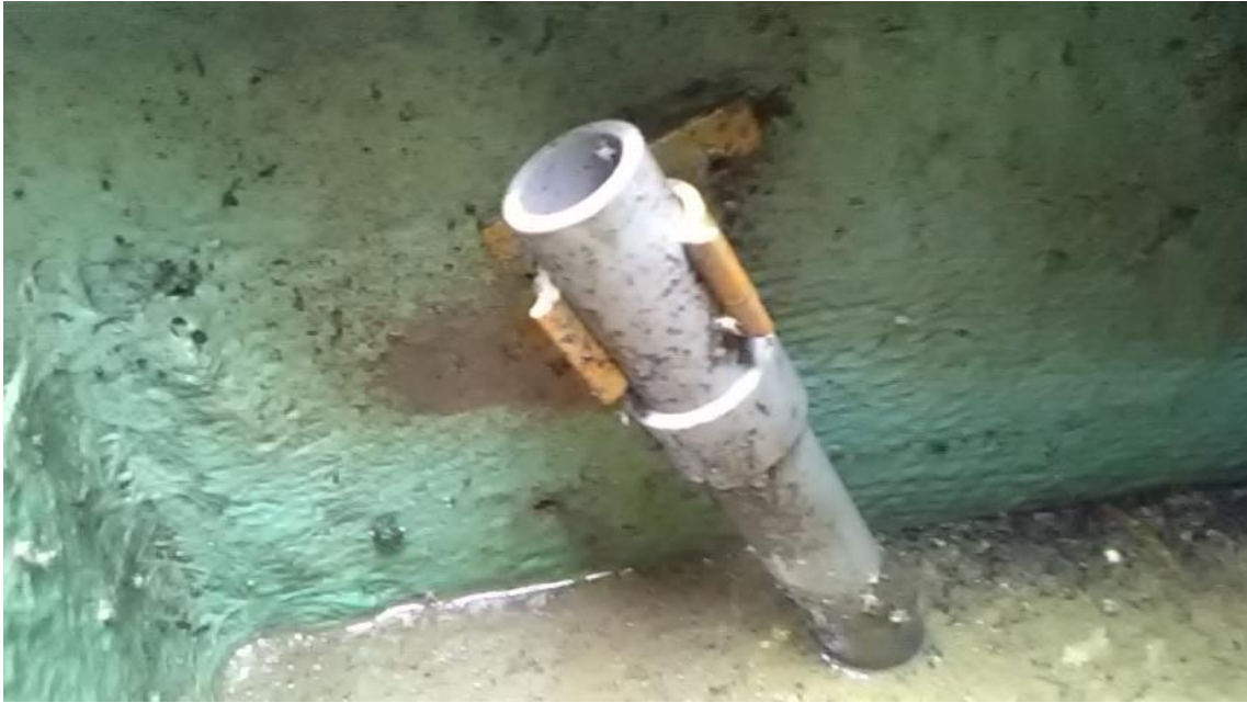
NO.15 嫌気ろ床槽のろ材押さえパイプホルダーのリベット腐食欠落のため、固定具が外れかかっている。
