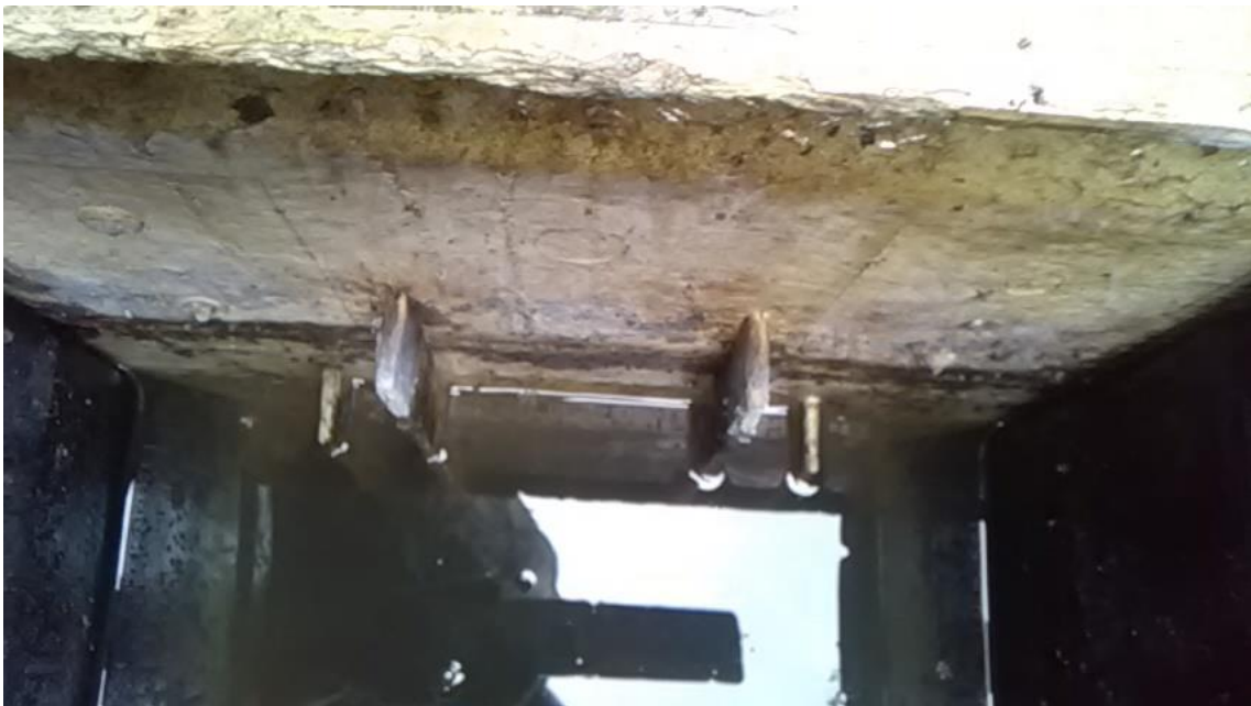
NO.6 嫌気ろ床槽隔壁に劣化が認められる。
