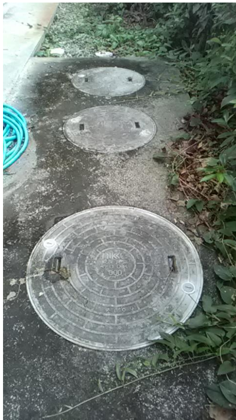
NO.4 槽上部の様子、マンホール蓋表面にやや劣化が見られるが人が乗って危険な状態ではない。
