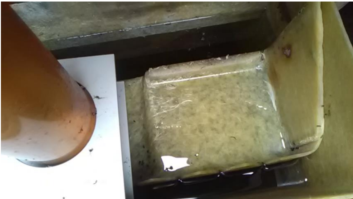
NO.16 越流ぜき固定用リベットに腐食が認められる
