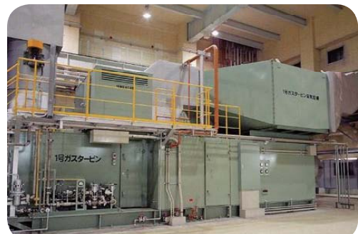
発電用のガスタービン
