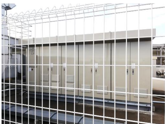
蓄電システム
