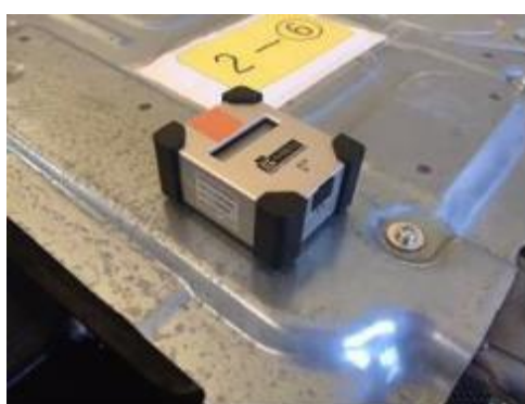
図 3-78 上段のロガーの設置状況
