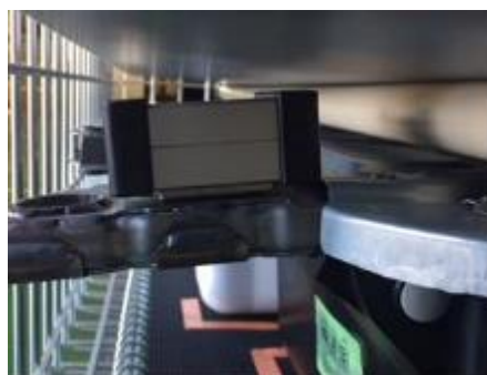
図 3-77 下段のロガーの設置状況②
