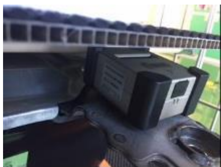
図 3-76 下段のロガーの設置状況①
