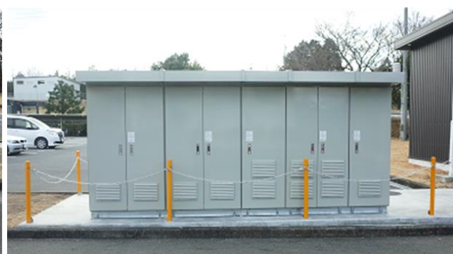
蓄電システム
