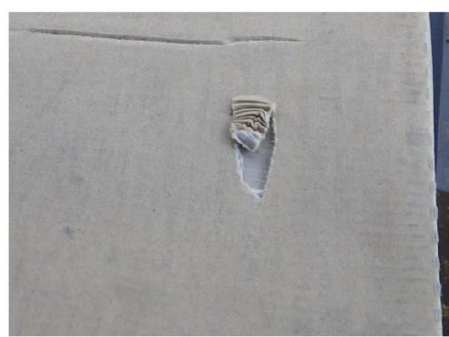
写真6 梱包材の破れ (パネルへの影響なし) ※梱包時または運搬時によるものと推定
