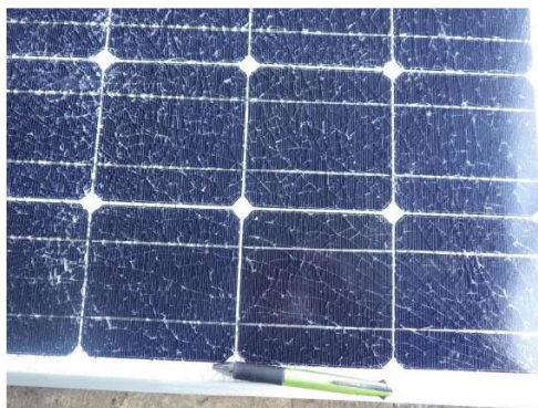
写真3 ガラス表面の細かいヒビ (搬送前から確認されていた)
