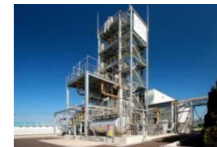
有害化学物質の放出を抑制可能な二酸化炭素分離回収設備
