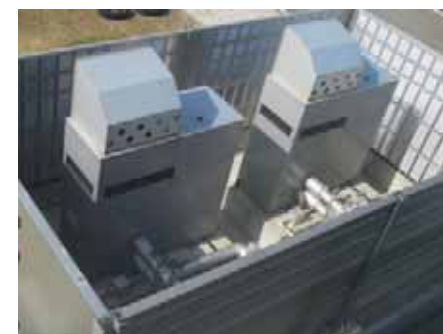
コージェネレーションシステム
