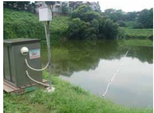
実証対象機器設置状況
