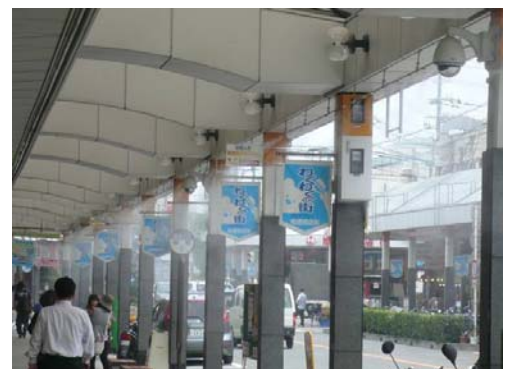
ミスト噴射装置の設置（大阪府吹田市）
