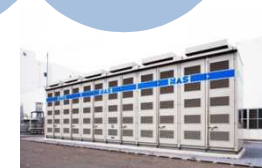
大容量蓄電池
