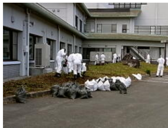
笹地表層土壌の除去
